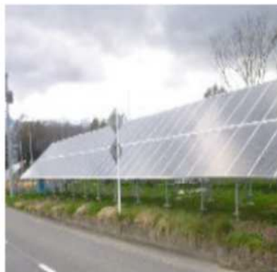
柵塀の設置されない設備
